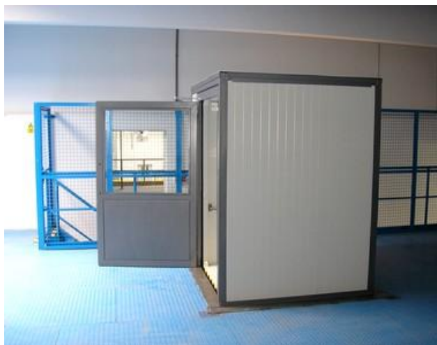
Horná stanica 1500 kg výťahu
